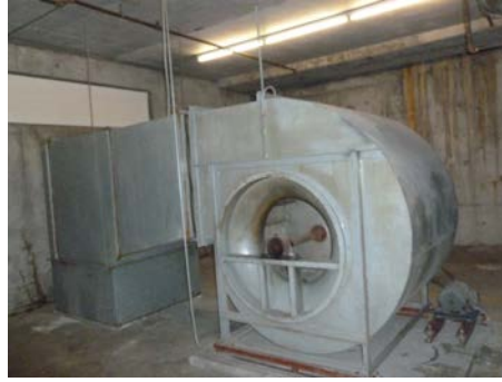
Garage Ventilation Fan
